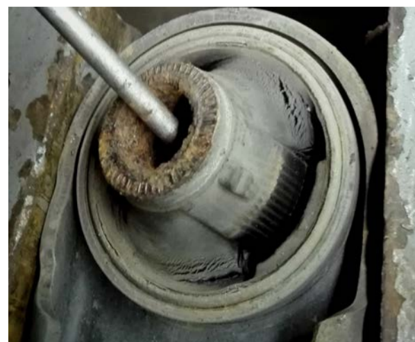
Próba wychylenia pokazuje jej faktyczny stan - pęknięcia dyskwalfikują dalszą eksploatację.
